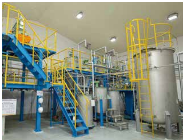
▲写真3 搾油設備
