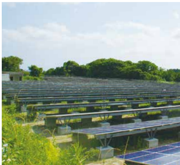
鹿児島県南九州市頰娃町 太陽光発電所
