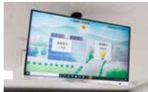
発電状況がわかるモニター
