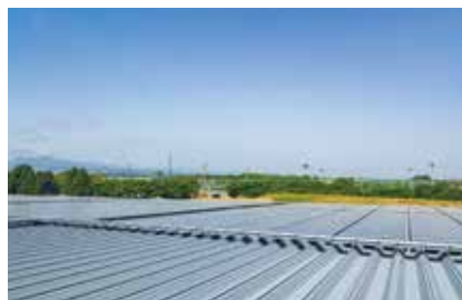
工場の屋上に設置された太陽光パネル
