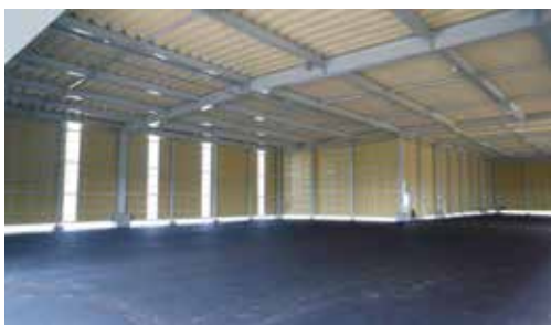
新設したライスセンター内部
