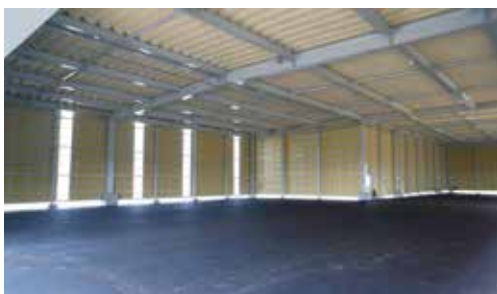
新設したライスセンター内部
