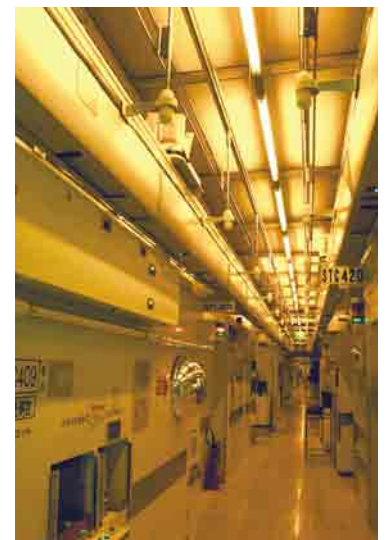
▲熊本川尻工場クリーンルーム内の様子（上方に天井搬送システムが見える）
