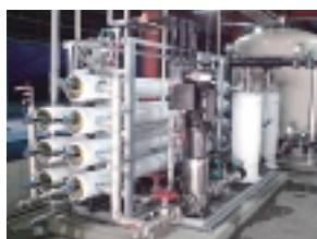
水処理プラント
