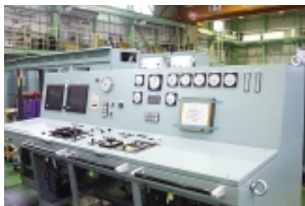
完成直前の計装システム
