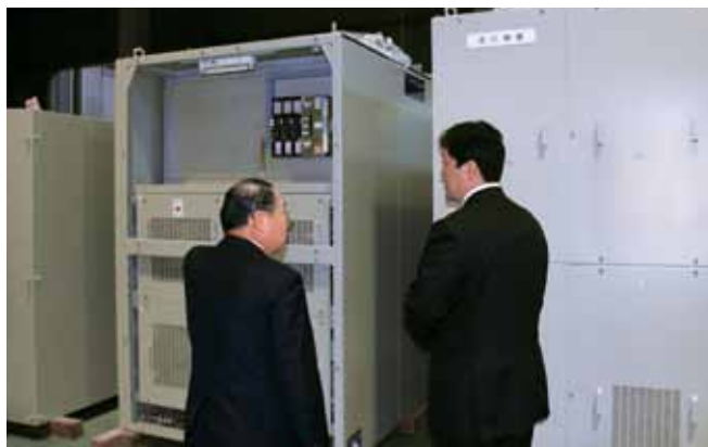
▲変圧器盤説明
