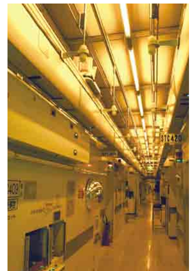
▲熊本川尻工場クリーンルーム内の様子（上方に天井搬送システムが見える）
