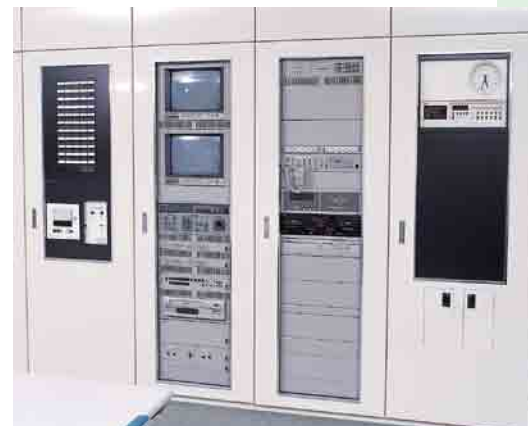
▲工場の管理システム
