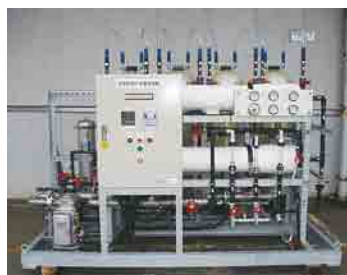
▲純水製造装置
