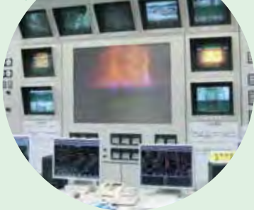
クリーンセンター中央監視システム
