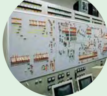
配合プラント中央監視盤
