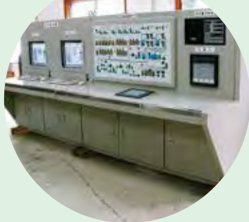
ごみ最終処分場監視盤
