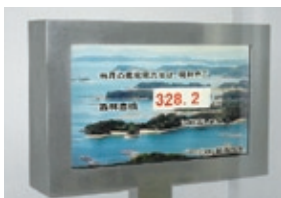
太陽光発電表示モニター(FFG佐世保ビル)
