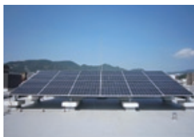
太陽光発電パネル(FFG佐世保ビル)
