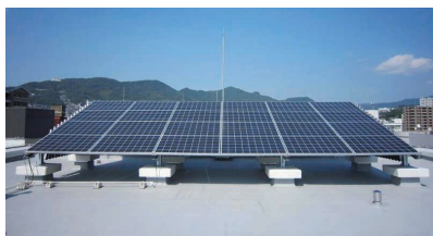
太陽光発電の設置
