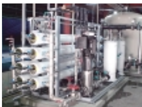
水処理プラント
