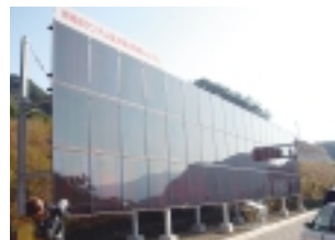
長崎市木鉢に設置された微結晶タンデム型太陽電池(8KW)
